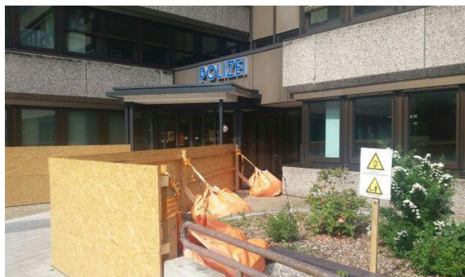
Absperrmaßnahmen an der Polizeiinspektion am Friedhofsweg aufgrund der bröckelnden Fassade. Bild: Bloch / Wahlkreisbüro.
